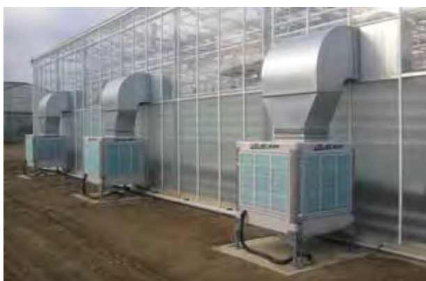
Instalación AD- 15-VS en invernadero
