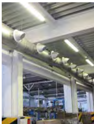
CI-300 Boca de impulsión
