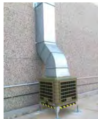
EC-18-VS instalado en pádel indoor
