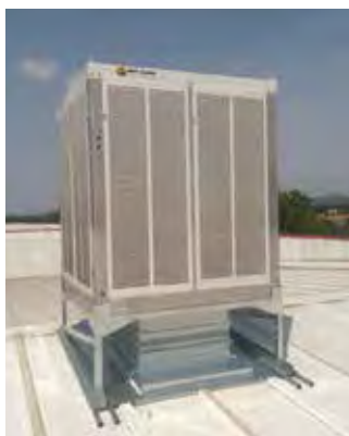
AD- 40-V en nave industrial
